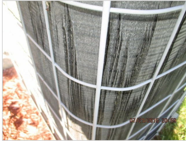
Damaged A/C fins
